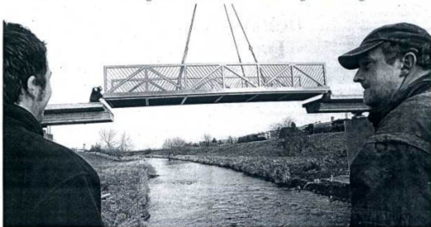
Vor den Augen der Bauleitung wird das Stahl-Element der Pleißerbrücke auf das Fundament gesetzt.
